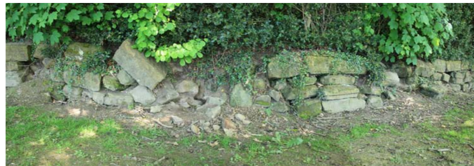
Existing Ha Ha wall in disrepair
